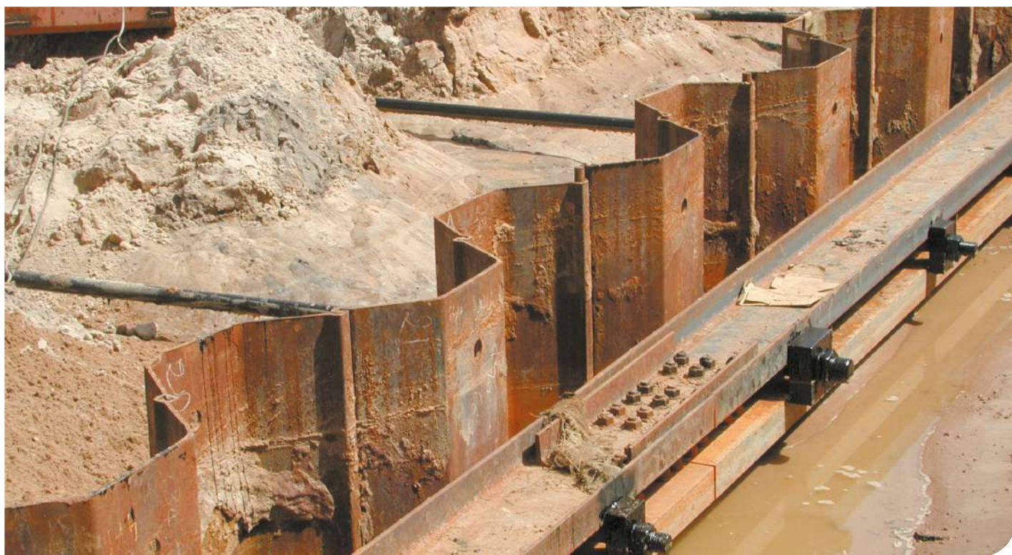
Sistema de Ancoragem
